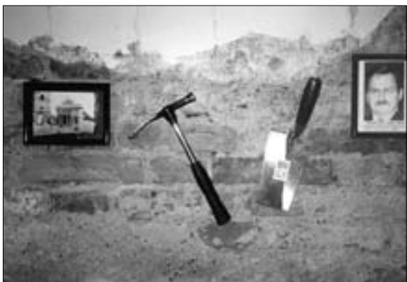
»Vendar kot vemo, štejejo le dejanja!« Županova misel na razpadajočem zidu gledališča
